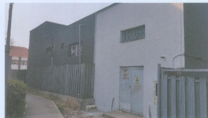
Vedere EST - post trafo existent
